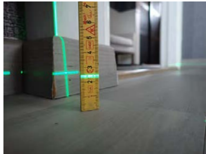
Referansenivå laser = 4 cm. Viser høydeforskjell på ca. 16 mm i stue i 1. etasje.
