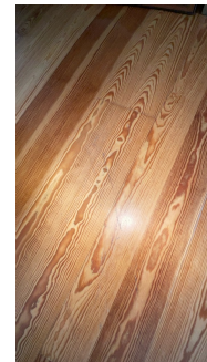
Noe slitasjemerker på gulv i stue
