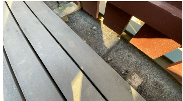
Synlig papptekking mellom terrassedekke og rekkverk
