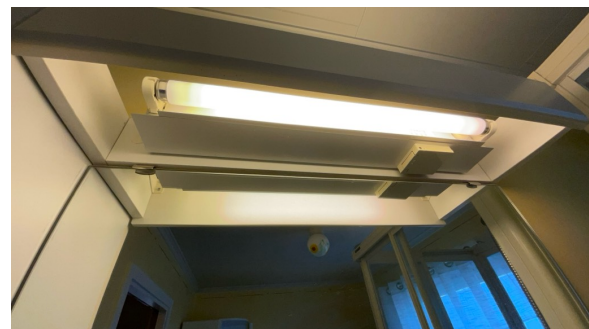
Deksel mangler på lysarmatur.
