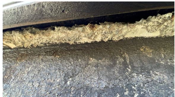
Skade på ytre del av betongdekke utenfor garasjemur
