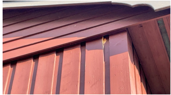
Liten skade på hjørne av bolig mot frittstående garasje.
