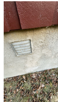
Riss i puss på oversiden av boligen.
