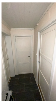
Dører til soverom/kontor, toalett og vaskerom. Dører bør justeres.
