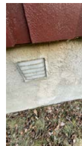
Riss i puss på oversiden av boligen.
