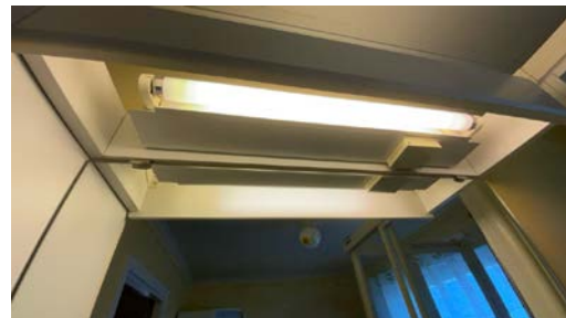
Deksel mangler på lysarmatur.
