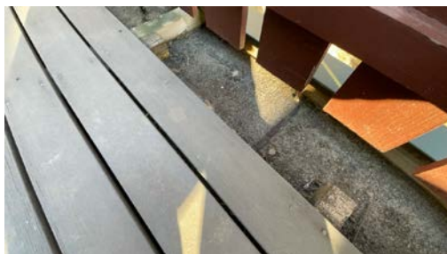
Synlig papptekking mellom terrassedekke og rekkverk
