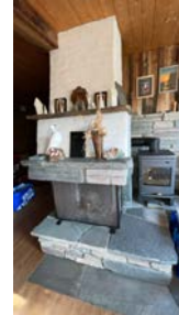
Åpen peis i underetasje sammen med rentbrennende peisovn
