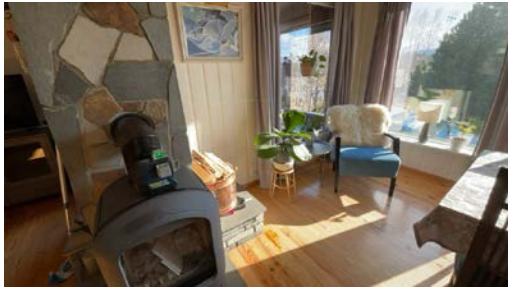
1. etasje Plassering av laser ved kontroll av stue. Det er målt 18 mm høydeforskjell gjennom rommet. TG 2. Over en avstand på 2 meter er det målt 10 mm fra peisovn mot senter av stue. TG 2
