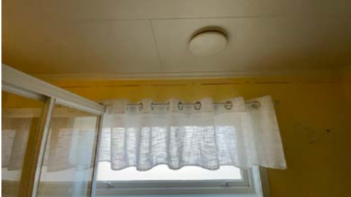
Avtrekksventil i himling
