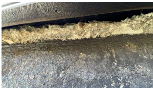
Skade på ytre del av betongdekke utenfor garasjemur
