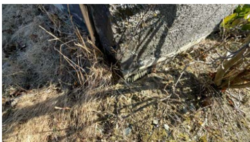
Synlig grunnmursplast på sidene
