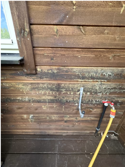
Kledningen skiller ut kvæ ved terrasse. Vedlikehold må påregnes.
