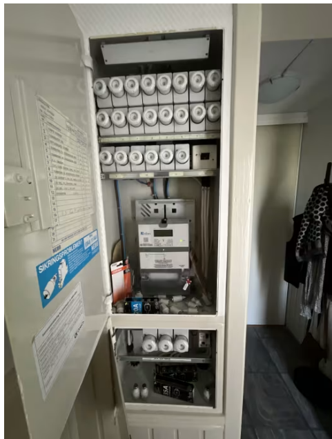
Viser innfelt sikringsskap plassert i gang. Inntak med jordkabel. Inntak på 3 x 35A.
