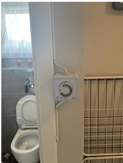
Viser hastighetsregulator antatt for toalettrom og bad. Reguleringen fremstår defekt.
