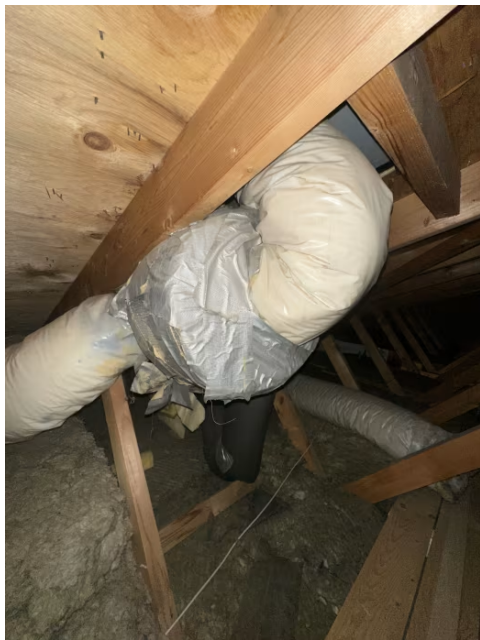
Viser vifte plassert på loft. Noe varierende kvalitet på isolering rundt ventilasjonsrør og vifte.
