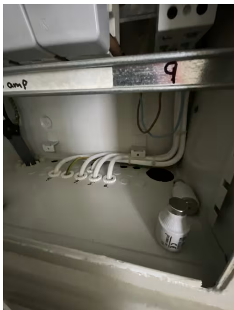
Det er hull/innføringer i inntak eller sikringsskap som ikke har nippelinnføringer.
