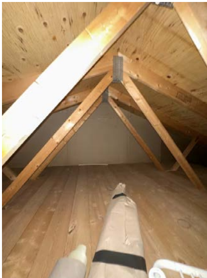
Viser loft og gipsplater i leilighetskille. Felt mellom sperrer uten etablert brannsikring.
