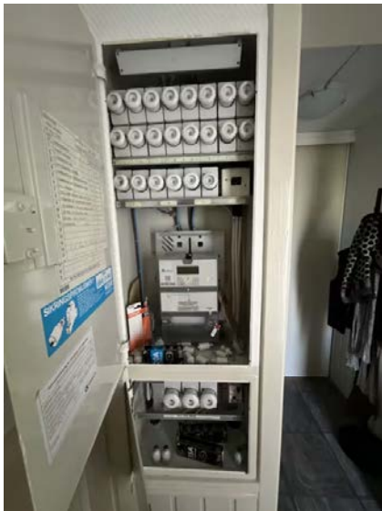
Viser innfelt sikringssskap plassert i gang. Inntak med jordkabel. Inntak på 3 x 35A.
