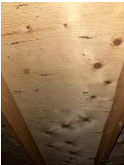
Synlige spiker igjennom undertak.
