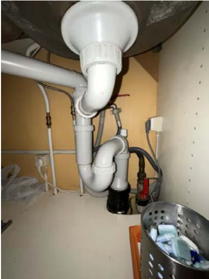
Viser vanninntak, hovedstoppekran og avløpsinstallasjoner under kum.
