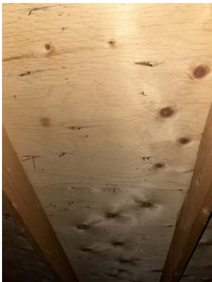
Synlige spiker igjennom undertak.
