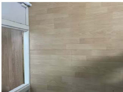
Det registreres sprekker i skjøter ved gulv.
