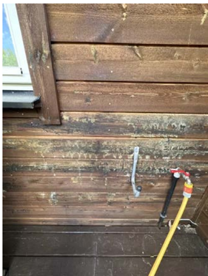
Kledningen skiller ut kvae ved terrasse. Vedlikehold må påregnes.
