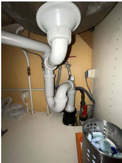
Viser vanninntak, hovedstoppekran og avløpsinstallasjoner under kum.
