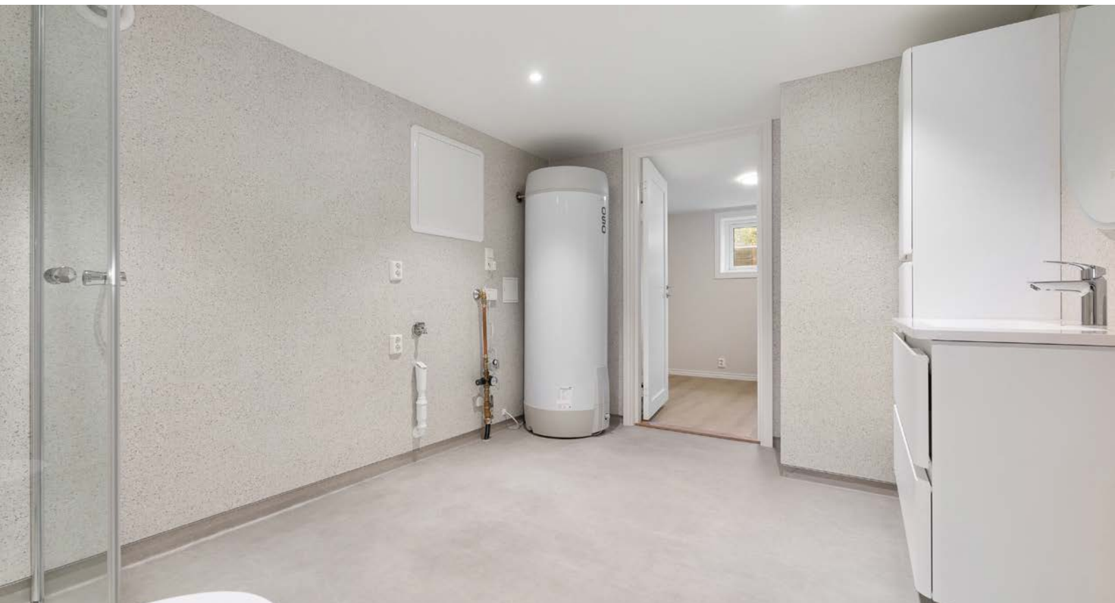
På badet er det opplegg for vaskemaskin og tørketrommel.
