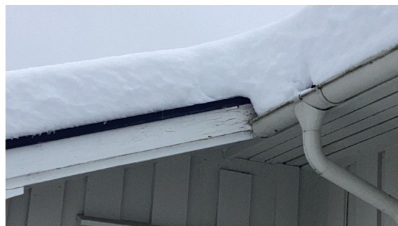
Eksempel på slitasje.
