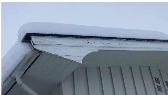
Eksempel på slitasje.
