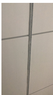
Det er stor glippe i plateskjøt under vindu.
