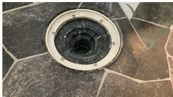
Sluk av plast med klemring.
