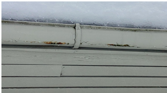
Lekkasje fra takrenne.
