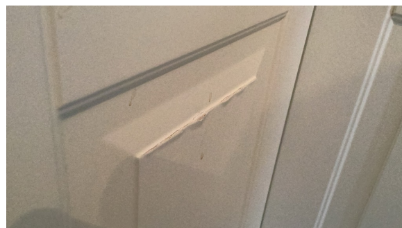
Eksempel på slitasje.
