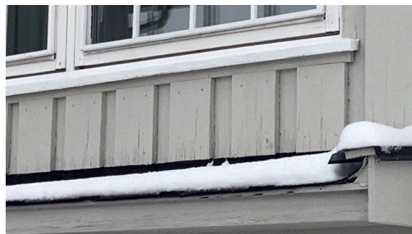
Eksempel på slitasje og sprekker.
