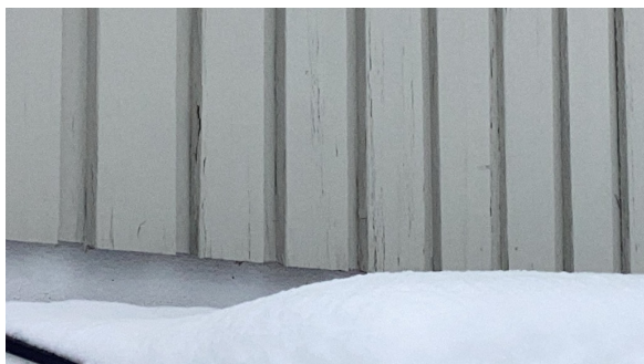
Eksempel på slitasje og sprekker.
