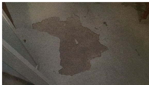
Avskaling av maling på gulv.
