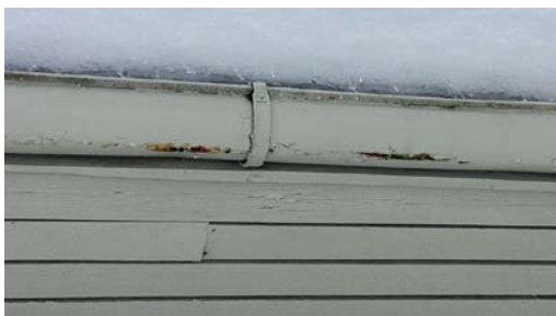
Lekkasje fra takrenne.
