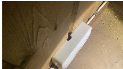
Eksempel på forhold som vil medføre avvik ved en el-kontroll.
