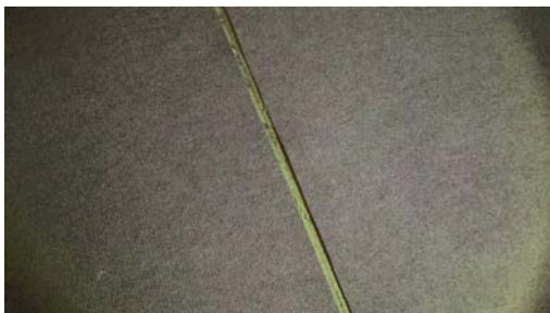
Glippe i skjøter på teppe
