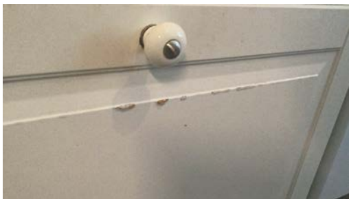
Eksempel på slitasje.
