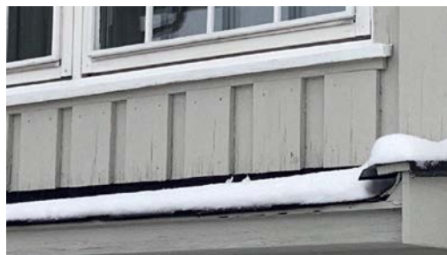
Eksempel på slitasje og sprekker.
