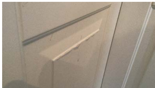
Eksempel på slitasje.
