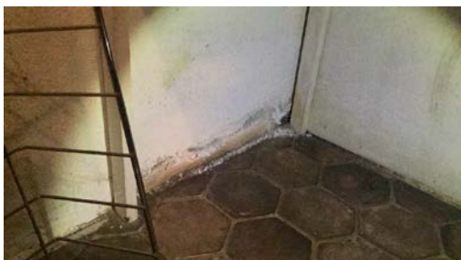
Stedvis tegn til fuktpåkjenninger nederst på vegger.
