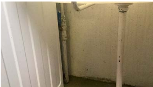
Vanninntak med stoppekran.
