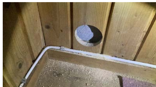
Det er foretatt hulltaking, men fuktmåling kunne ikke utføres.
