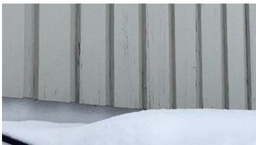
Eksempel på slitasje og sprekker.
