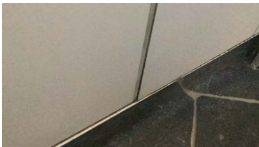
Glippe/begynnende skade i plateskjøt i dusjsonen
