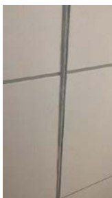
Det er stor glippe i plateskjøt under vindu.
