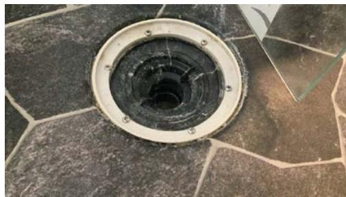
Sluk av plast med klemring.
