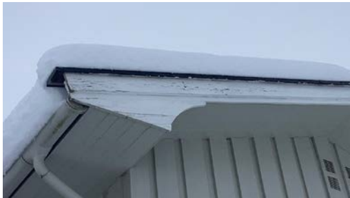
Eksempel på slitasje.
