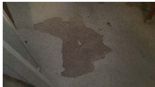
Avskaling av maling på gulv.
