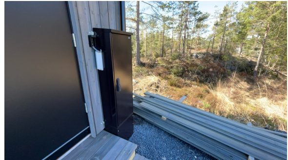
Utvendig skap med hovedsikringer og måler.
