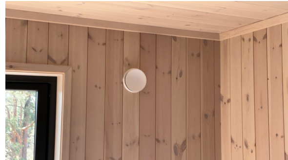
Eksempel på montert ventil i vegg.
