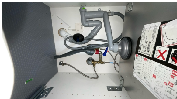
Del av rør til vann.
