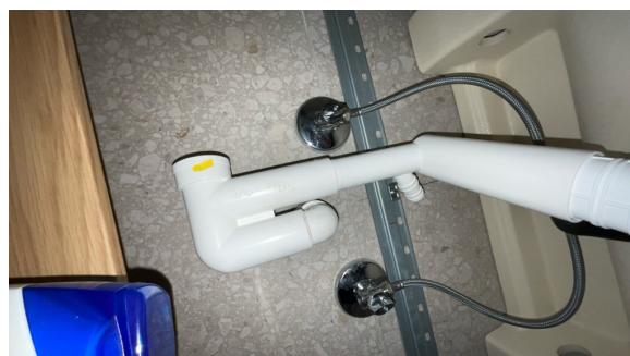
Del av rør til avløp.
