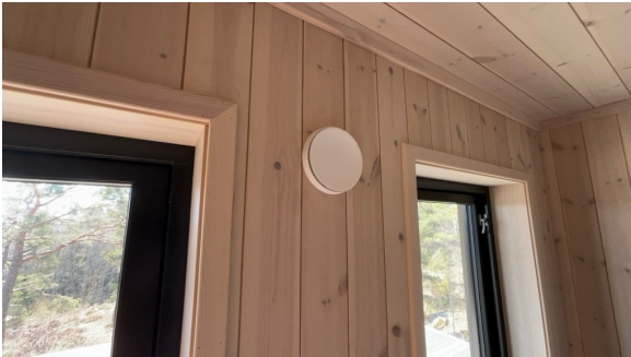
Eksempel på montert ventil i vegg.
