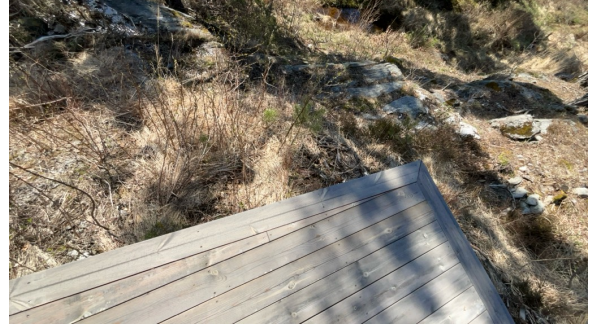
Eksempel på område som mangler rekkverk.
