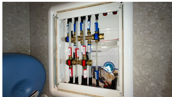
Skap til rør i rør system.
