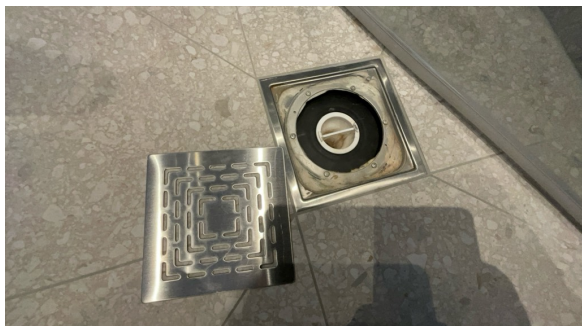
Sluk i gulv.
