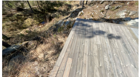
Eksempel på område som mangler rekkverk.
