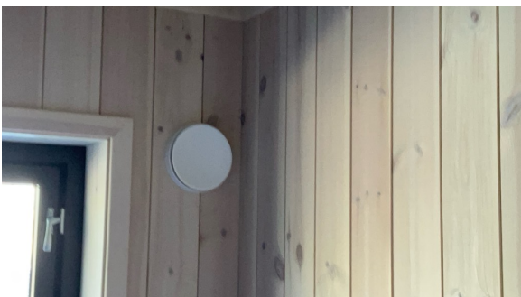
Eksempel på montert ventil i vegg.
