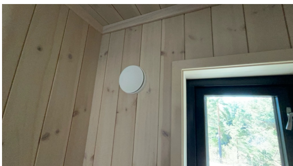
Del av toalettrom.
