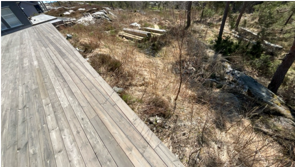
Eksempel på område som mangler rekkverk.
