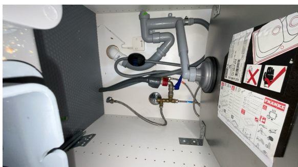
Del av rør til avløp.
