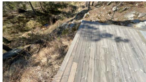
Eksempel på område som mangler rekkverk.
