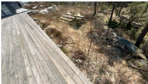
Eksempel på område som mangler rekkverk.
