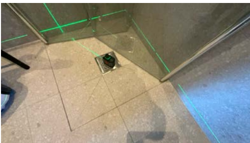
Målt fall på gulv.
