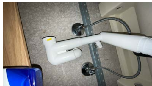
Del av rør til avløp.
