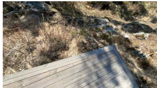
Eksempel på område som mangler rekkverk.
