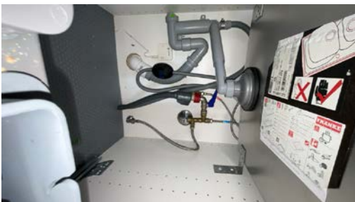
Del av rør til avløp.
