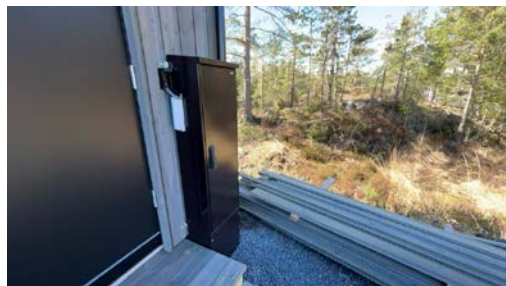
Utvendig skap med hovedsikringer og måler.
