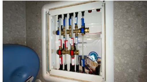
Skap til rør i rør system.
