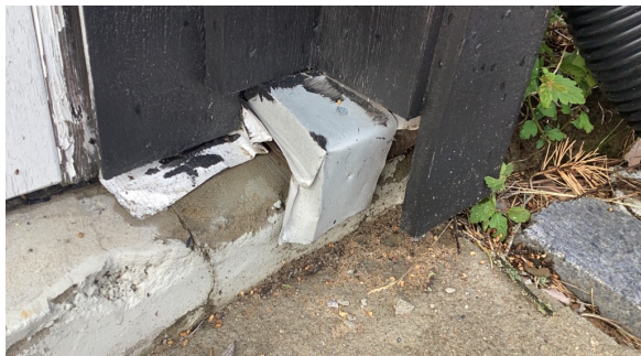
Svak løsning for fuktsikring av konstruksjoner.
