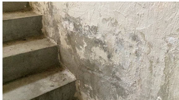
Saltutslag og avskaling på mur.
