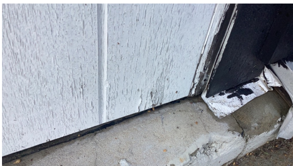
Slitasje på dør.
