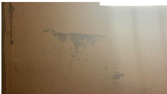
Eksempel på avskaling på vegg
