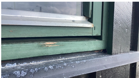
Noen vinduer har slitasje
