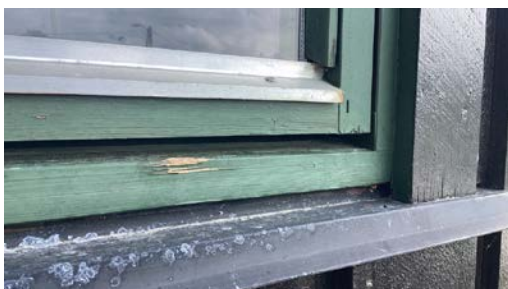
Noen vinduer har slitasje
