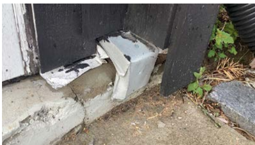
Svak løsning for fuktsikring av konstruksjoner.
