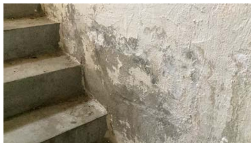
Saltutslag og avskaling på mur.
