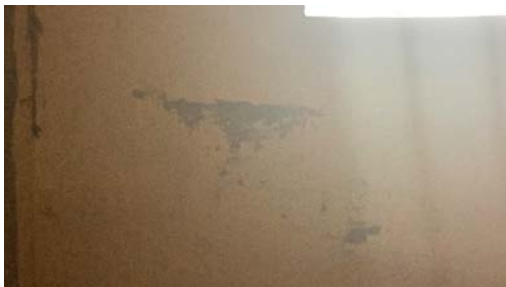
Eksempel på avskaling på vegg
