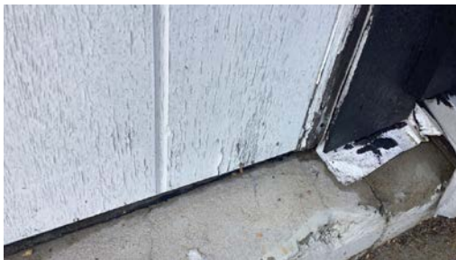
Slitasje på dør.
