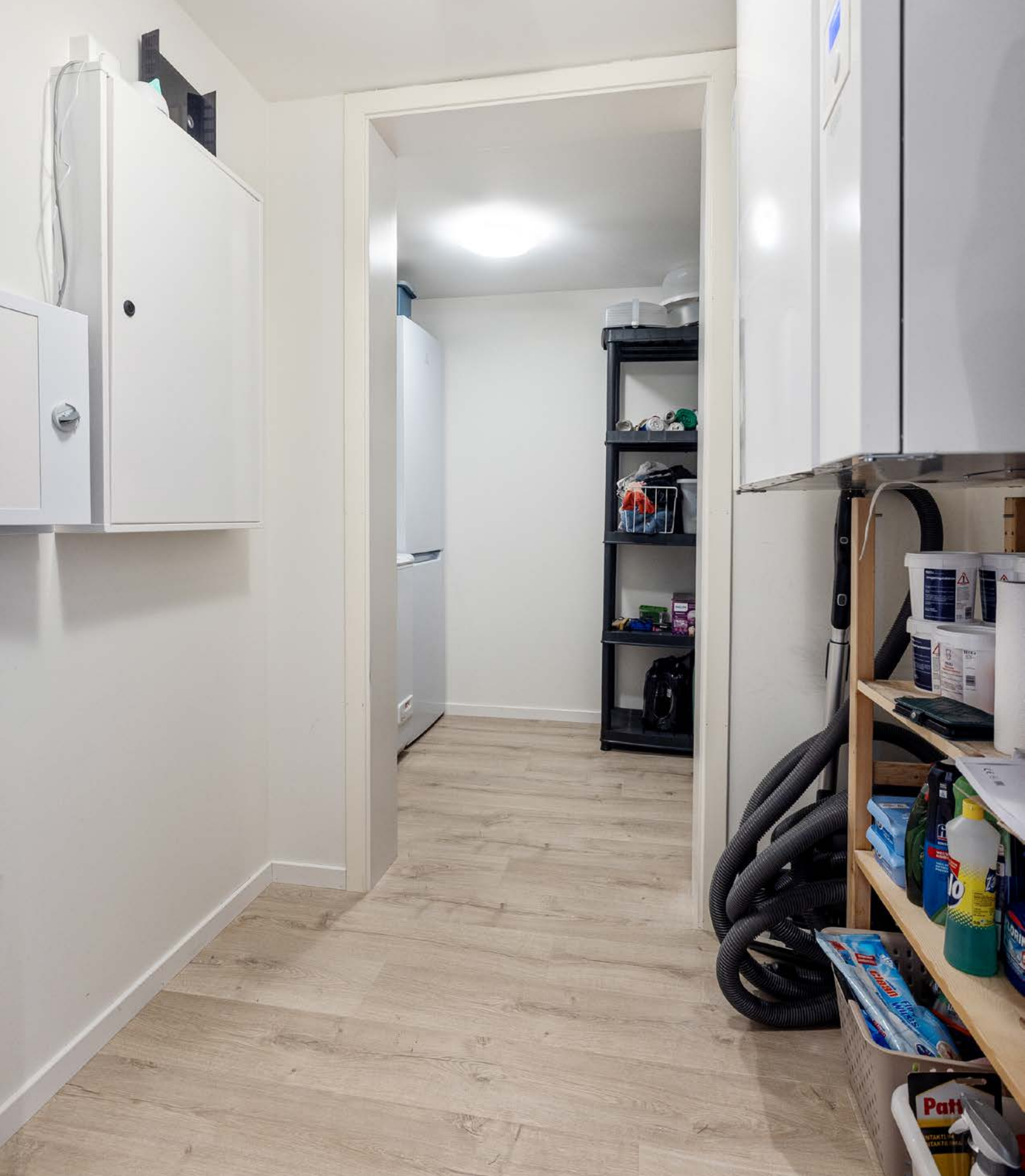
Teknisk rom i 1. etasje med sentralstøvsuger.
