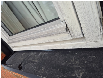
Værslitt treverk på vinduer mot syd.
