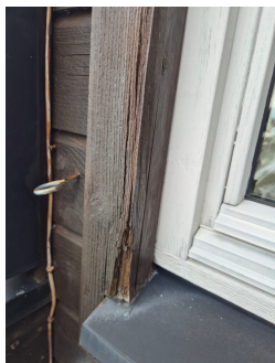
Råte i listverk rundt kontorvindu.
