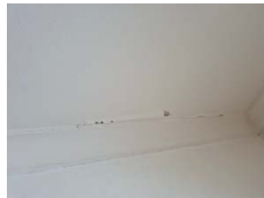
Sprekker mot pipe.
