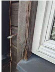
Råte i listverk rundt kontorvindu.
