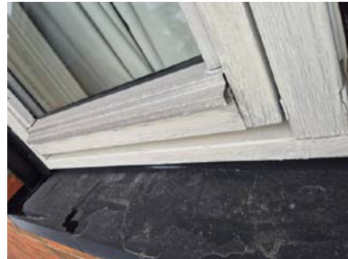
Værslitt treverk på vinduer mot syd.
