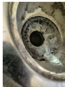
Sluk under varmtvannsbereder.
