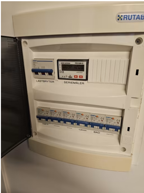
Sekundær sikringskap i utleiedel.
