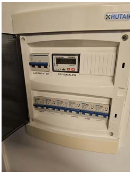
Sekundær sikringskap i utleiedel.
