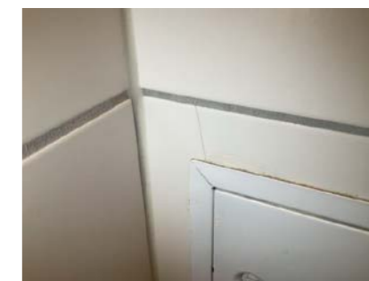
Sprekk i flis over luke.
