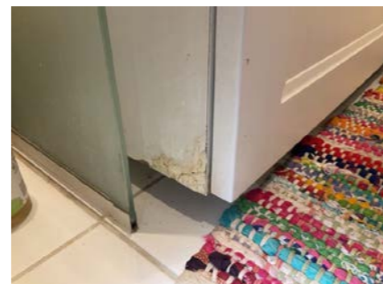
Fuktskade på servantskap.
