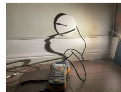
Fuktmåling bak dusjen.
