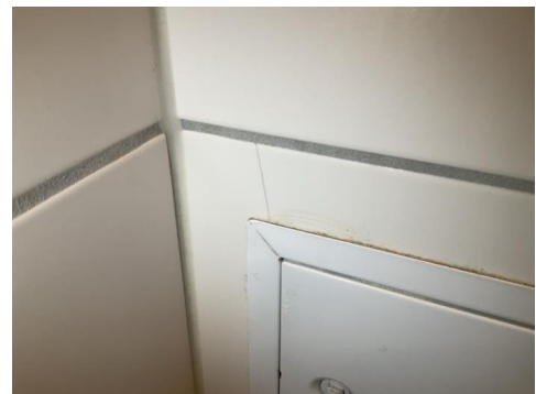
Sprekk i flis over luke.
