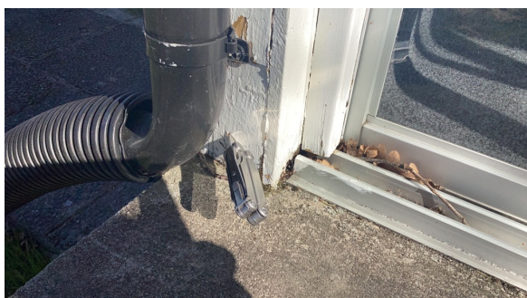
Råte i kledning rundt søyle.
