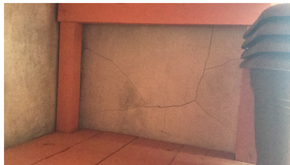
Eksempel på sprekk i grunnmur.
