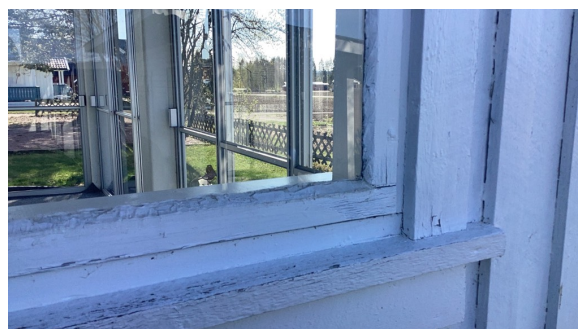
Oppsprekking i kitt.
