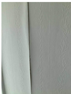
Eksempel på tapet som løsner i skjøt.
