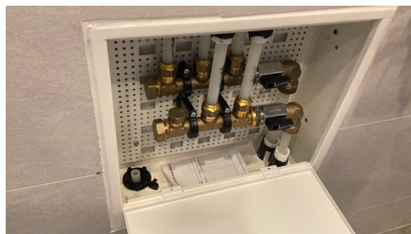
Forderskap for vannrør på bad. Ukjent løsning for håndtering av lekkasjevann
