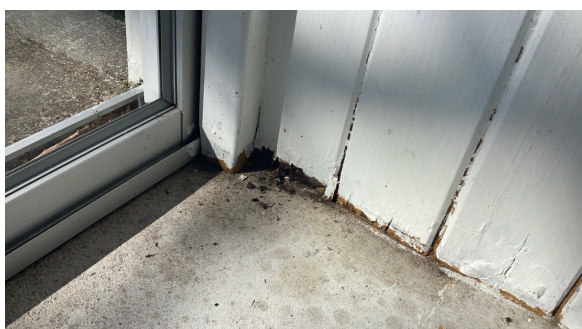
Fuktpåkjenninger på vegg.
