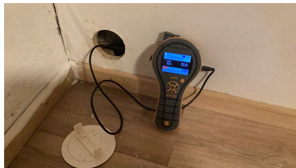
Fuktmåling i utforet trevegg på 2 vektprosent.
