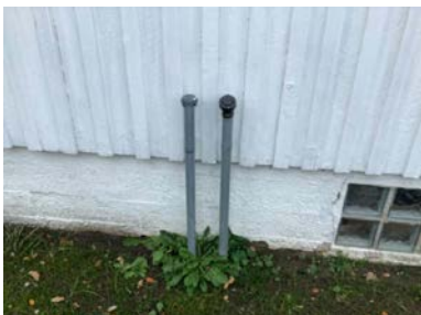
Nedgravet oljetank på eiendommen.
