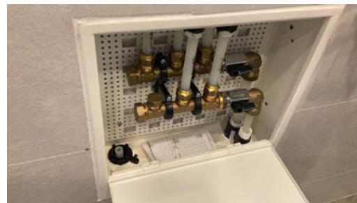
Fordelerskap for vannrør på bad. Ukjent løsning for håndtering av lekkasjevann
