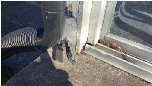
Råte i kledning rundt søyle.
