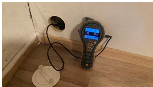
Fuktmåling i utforet trevegg på 2 vektprosent.
