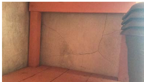
Eksempel på sprekk i grunnmur.
