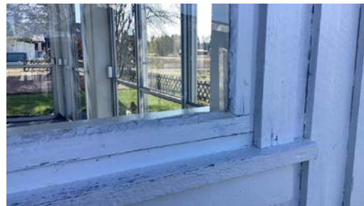
Oppsprekking i kitt.
