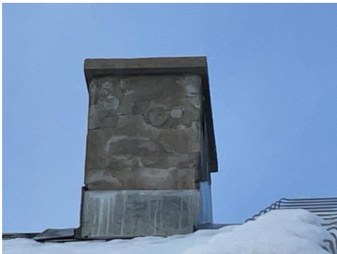
Slitasje og sprekkdannelse på pipe over tak
