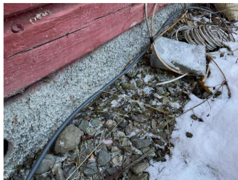
Ingen synlig fuktsikring
