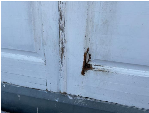
Skade på ytterdør
