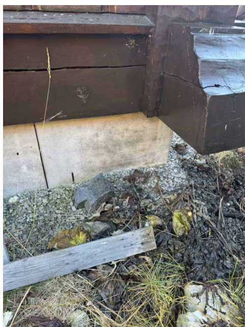
Kun mindre fuktmerker på hjørne med taknedløp.
