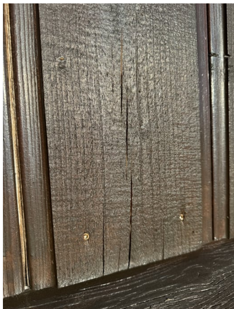
Paneller med oppsprekking.
