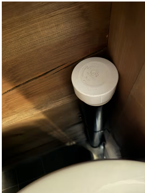
Durgoventil som lufting av kloakk.
