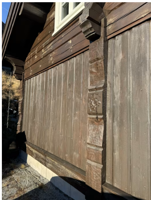
I stor grad fungerende yttervegger.
