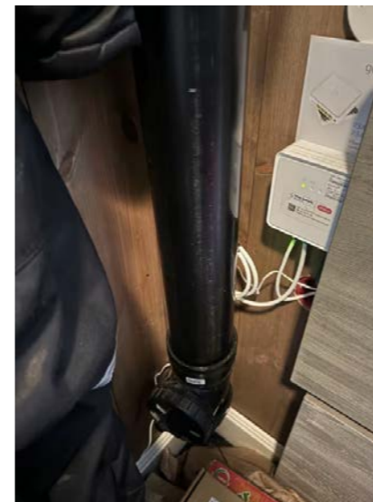
Stakeluke på avløpsrør.
