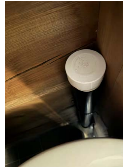
Durgoventil som lufting av kloakk.
