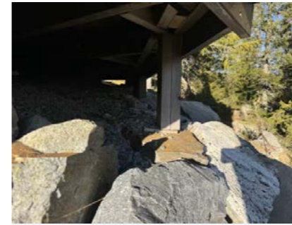
Noe svakt fundament på dette hjørne, men ingen store skjevheter.
