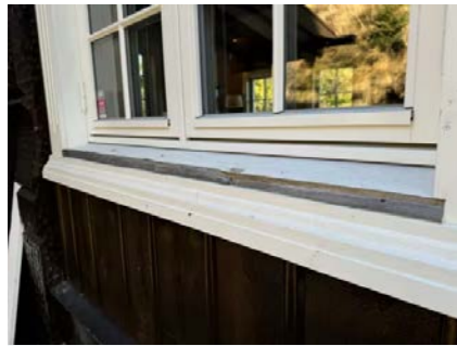
Knekt vannbrett. Det er ikke beslag som går inn i spor på vindu, slik montering kan føre til vanninntrenging og skader.
