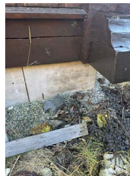
Kun mindre fuktmerker på hjørne med taknedløp.
