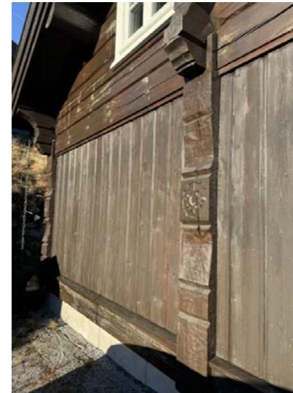
I stor grad fungerende yttervegger.
