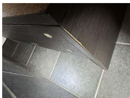
Mindre fuktmerker på innredning.
