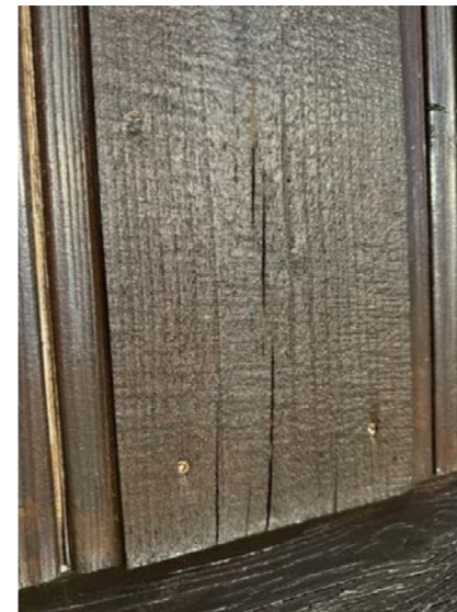
Paneler med oppsprekking.
