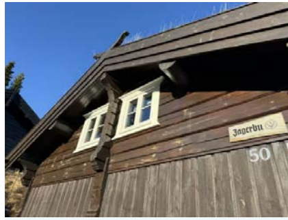
I stor grad fungerende yttervegger.
