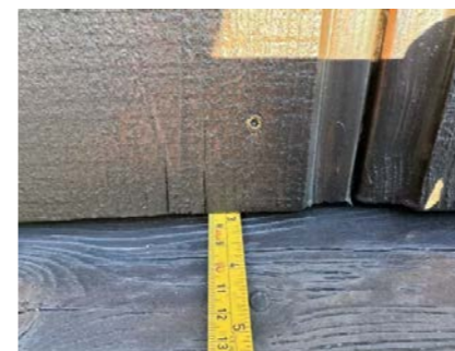
Høyst sannsynlig luftespalte bak kledning.
