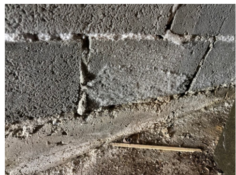
Kalkutslag på innsiden av mur i krypkjeller.
