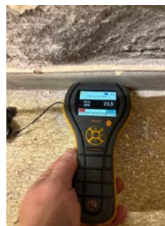
Høyt fuktinnhold i gulvlist i trappegang
