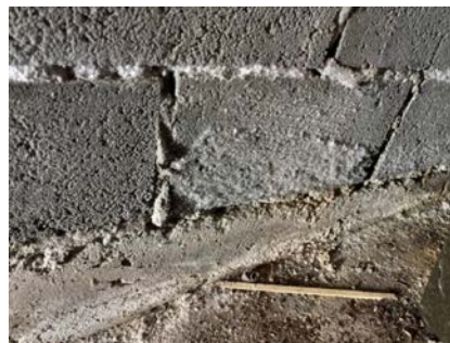
Kalkutslag på innsiden av mur i krypkjeller.
