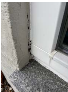
Vindu må tettes bedre mellom karm og mur.
