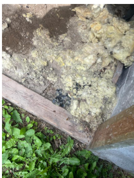
Synlig rester etter skadedyr (ekskrementer fra mus)
