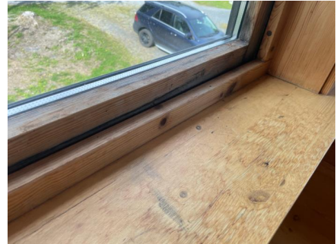
Tegn til mugg/svertesopp i vinduskarmen innvendig
