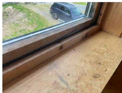
Tegn til mugg/svertesopp i vinduskarme innvendig
