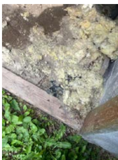
Synlig rester etter skadedyr (ekskrementer fra mus)
