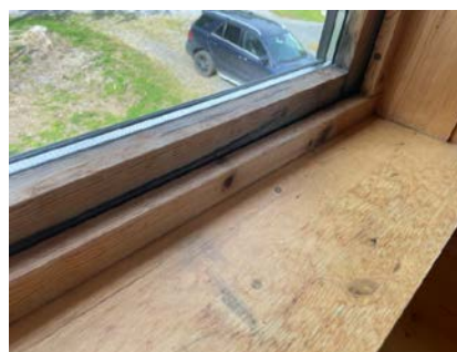
Tegn til mugg/svertesopp i vinduskarmen innvendig
