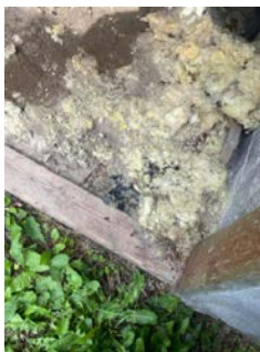
Synlig rester etter skadedyr (ekskrementer fra mus)
