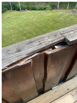
Værslitt rekkeverk og synlig skade i håndløper
