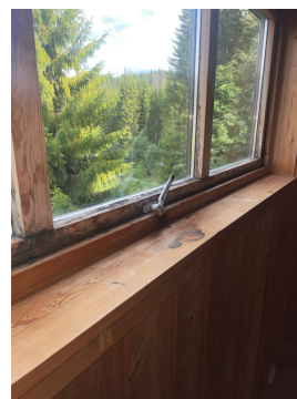
Synlig mugg/svertesopp i vinduskarmer
