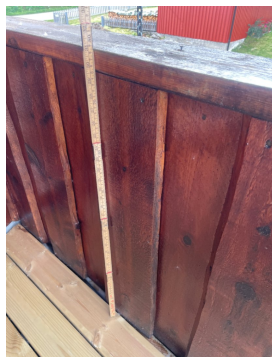
Rekkeverk er for lavt jmf. regelverk ved byggeår
