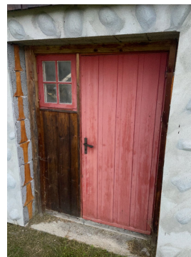
Eksempel på værslitt ytterside.
