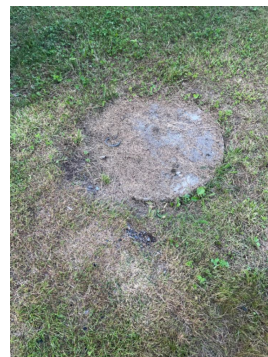
Betongkum på nedside av bolig.
