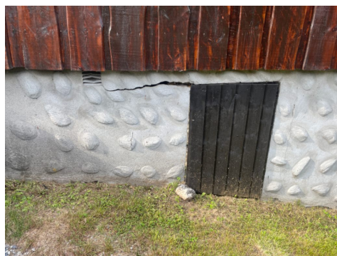
Setningsskade i mur.
