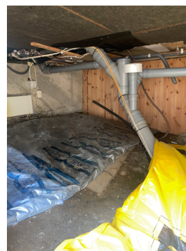
Vannrør i kryperom er utsatt for kulde.
