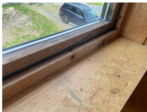
Synlig mugg/svertesopp i vinduskarmer
