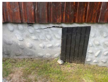
Setningsskade i mur.
