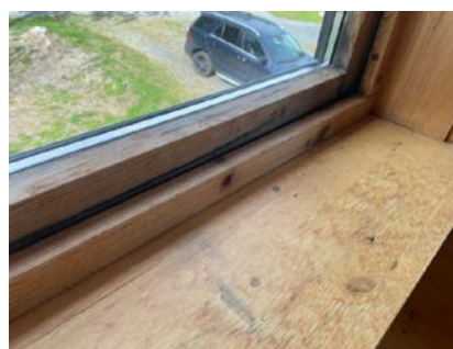
Synlig mugg/svertesopp i vinduskarmer
