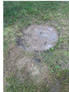
Betongkum på nedside av bolig.
