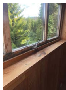
Synlig mugg/svertesopp i vinduskarmer
