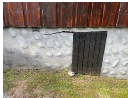
Setningsskade i mur.
