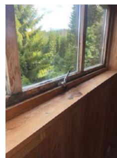
Synlig mugg/svertesopp i vinduskarmer
