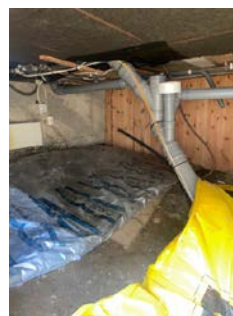
Vannrør i kryperom er utsatt for kulde.
