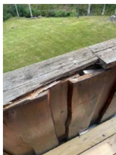
Værslitt rekkverk og synlig skade i håndløper
