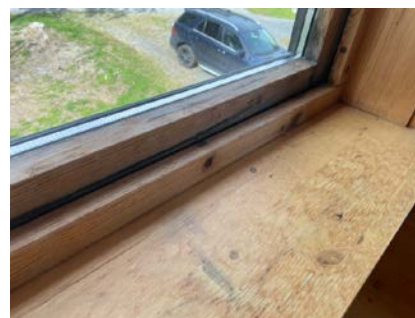
Synlig mugg/svertesopp i vinduskarmer
