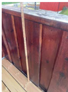
Rekkverk er for lavt jmf. regelverk ved byggeår
