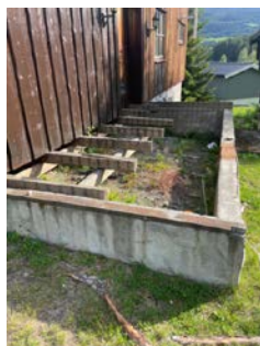
Området på bygget hvor det er registrert skeivheter.
