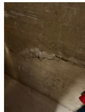
Sprekk i grunnmur, kjellerbod.
