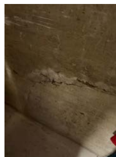
Sprekk i grunnmur, kjellerbod.
