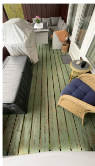
Det er værslitt/oppsprukket trevirke/trepaneler.
