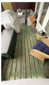
Det er værslitt/oppsprukket trevirke/trepaneler.
