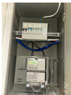
Sikringsskap med automatsikringer.
