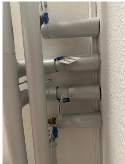
Stoppekran plassert i felles gang
