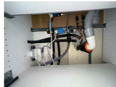
Røropplegg i kjøkkenbenk med Waterguard
