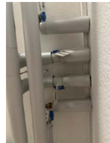
Stoppekran plassert i felles gang
