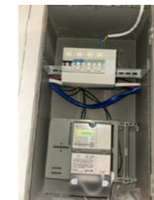
Sikringsskap med automatsikringer.
