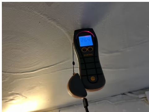
Fukt påvist i himling utvendig bod i underetasje.
