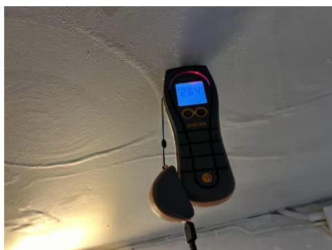
Himling i utv. bod viser fukt verdier på 26,7 %
