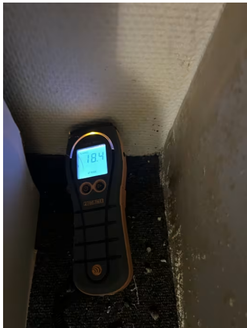
Fuktverdier registrert i påført vegg hobbyrom i underetasje (mot terrasse)
