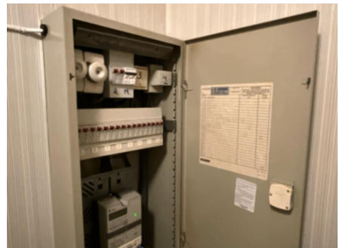
Foto av sikringskap
