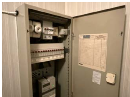
Foto av sikringskap
