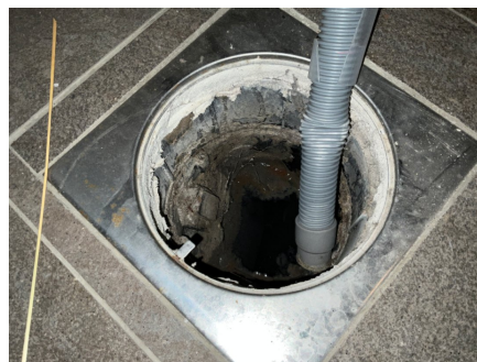
Ingen synlig membran i sluken.
