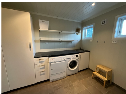
Ikke fuktbestandige plater på veggene.
