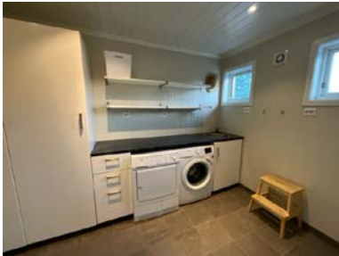
Ikke fuktbestandige plater på veggene.
