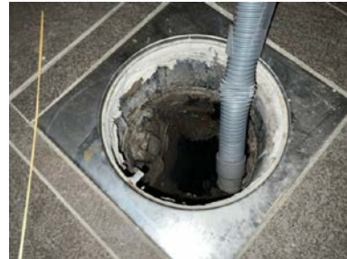
Ingen synlig membran i sluken.
