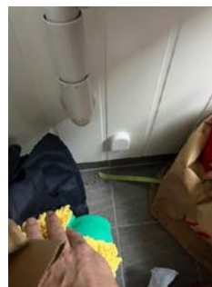
Rør i rør med fordelserskap på vaskerom
