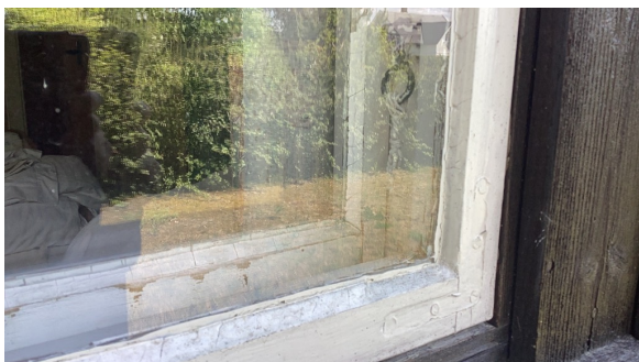
Eksempel på slitasje.
