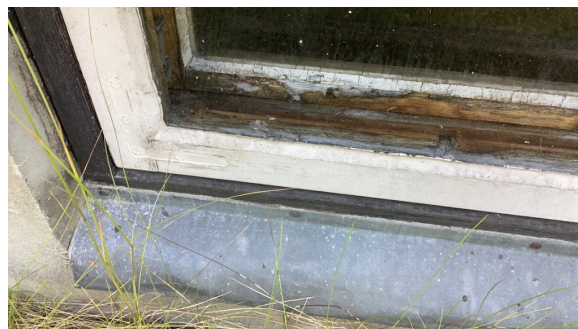
Eksempel på slitasje.
