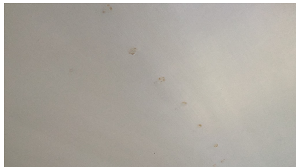
Misfarging i himling på kjøkken.
