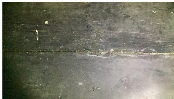
Sprekk i gulvbelegg.
