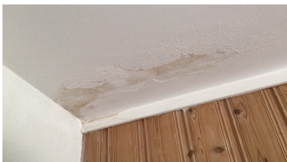
Slitasje i himling ved pipe.
