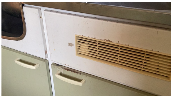
Eksempel på slitasje.
