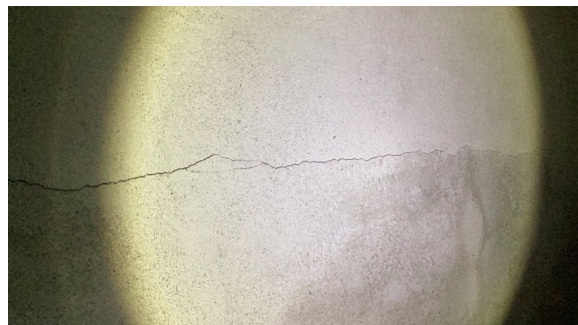
Eksempel på sprekk i grunnmur.
