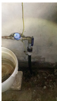
Vanninntak med måler og stoppekran.
