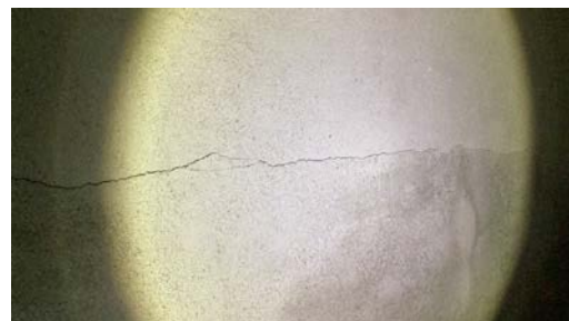
Eksempel på sprekke i grunnmur.
