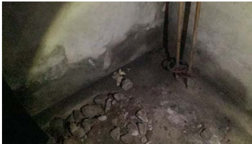
Eksempel på fuktpåkjenning på overflate.
