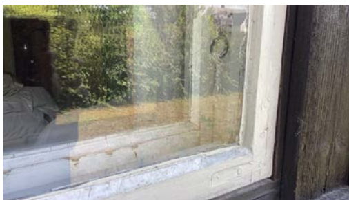
Eksempel på slitasje.
