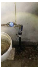
Vanninntak med måler og stoppekran.
