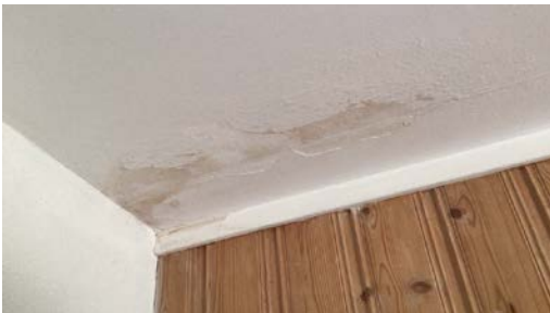
Slitasje i himling ved pipe.
