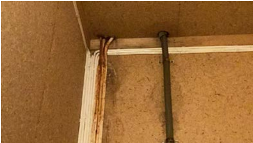
Tegn etter at det har rent inn vann i trapperom.
