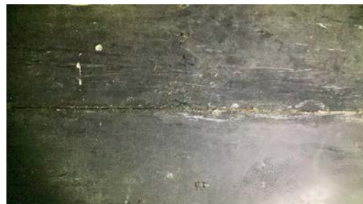
Sprekk i gulvbelegg.
