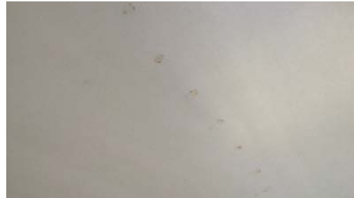
Misfarging i himling på kjøkken.
