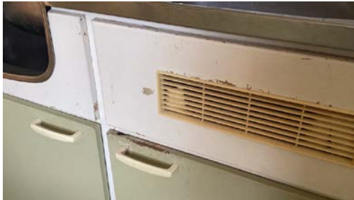
Eksempel på slitasje.
