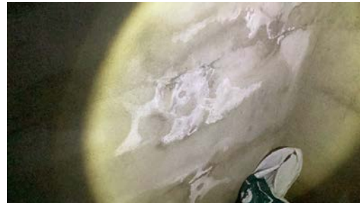
Eksempel på fuktpåkjenning på overflate.
