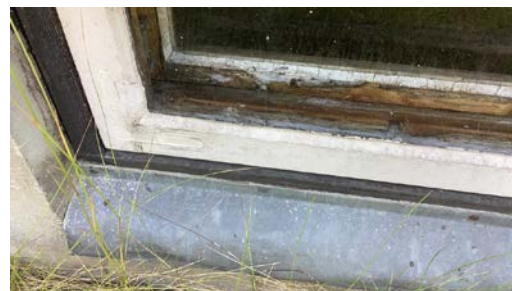
Eksempel på slitasje.
