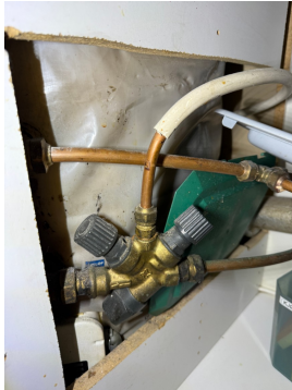
Varmtvannsbereder under benkeskap på kjøkken
